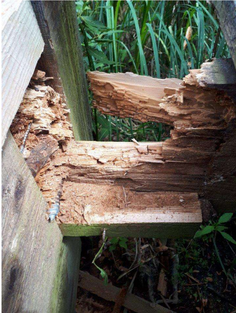
C:\Users\Sara Tienkamp\Documents\Boardwalk Decay 1.jpg
