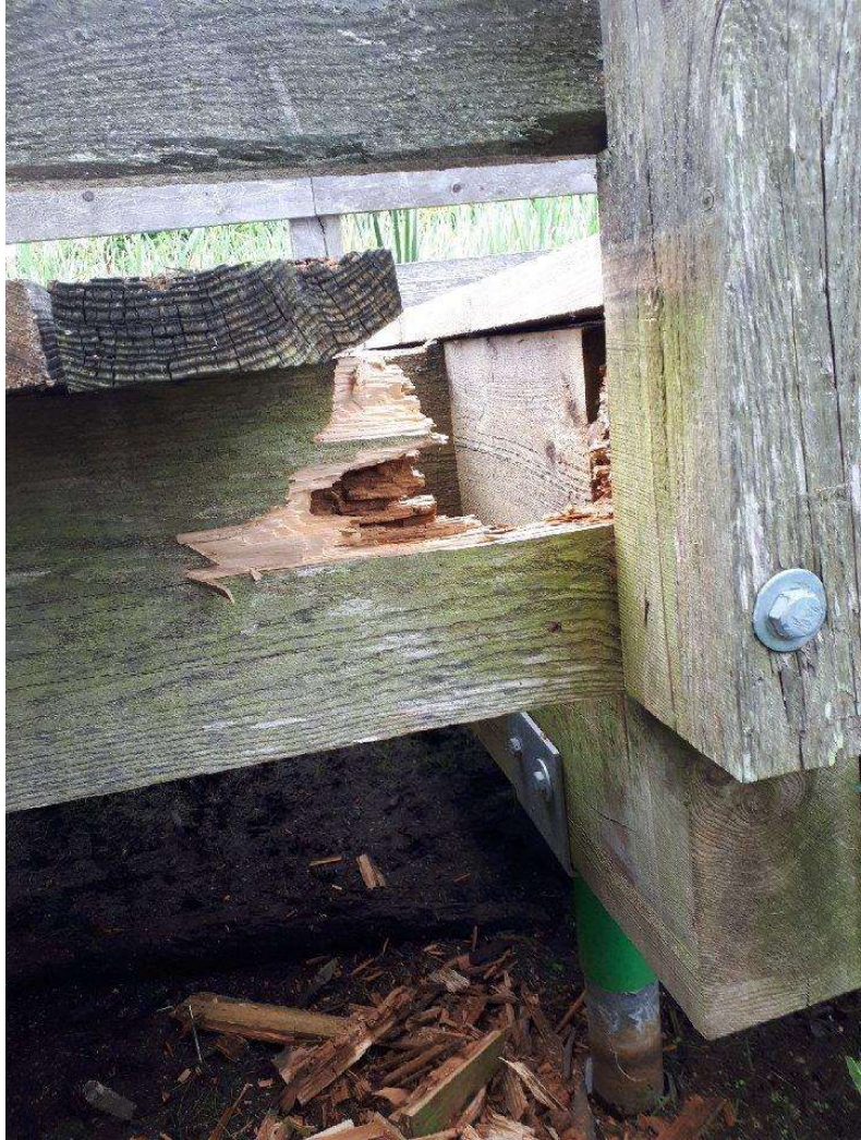
C:\Users\Sara Tienkamp\Documents\Boardwalk Decay 2.jpg
